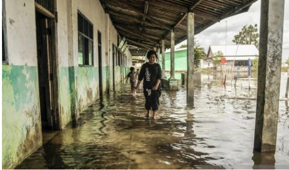
Gambar 2 Foto Bangunan Sekolah Terendam Rob di Pantura
